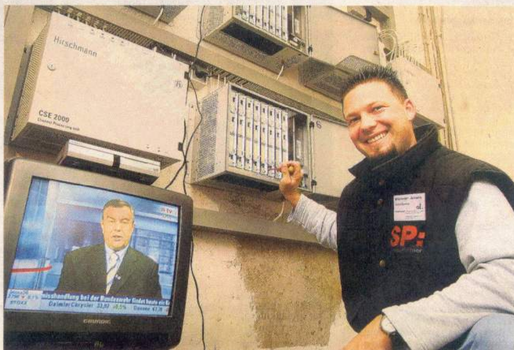
Stefan Smeets in der Technik-Zentrale der Hochdahler Hochhäuser, die 300 Wohnungen mit TV- und Radiosignalen versorgt. Der Auftrag ist gewissermaßen der Abschluss seiner Lehrzeit zum Informationstechniker. RP-FOTO: DIETRICH JANICKI
